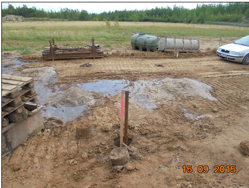
Bild 16: RB II/15 – eingebauter Riegelsack
